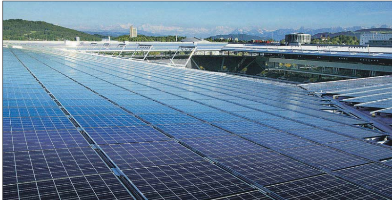
Das Stade de Suisse in Bern: Die weltweit größte dachintegrierte Photovoltaikanlage auf einem Fußballstadion. Eines der großen internationalen Solarprojekte der Firma TRITEC, die ihren Stammsitz in der Schweiz hat.
